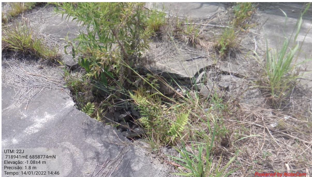
Figura 15: Vista de resto de pavimento de concreto dentro do imóvel vistoriado. Fonte: autor, 2022.
