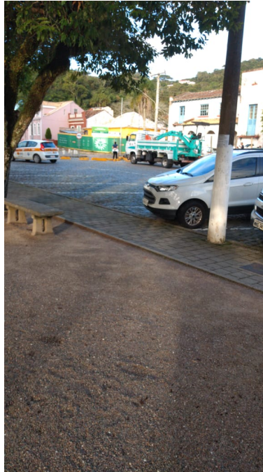
Ilustração 1: Perfuração de tubulação da CASAN após o início da execução irregular do tapume.
