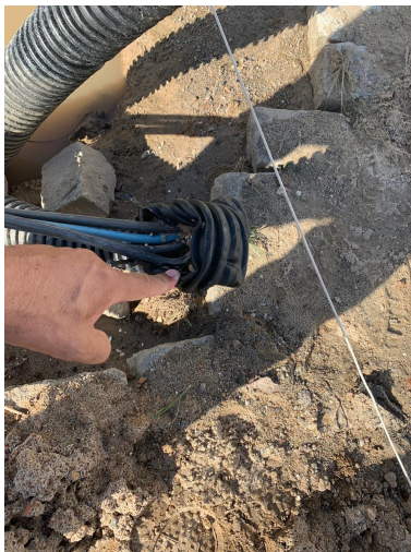
Ilustração 4: Dano causado (imagem mais aproximada) da fiação.
