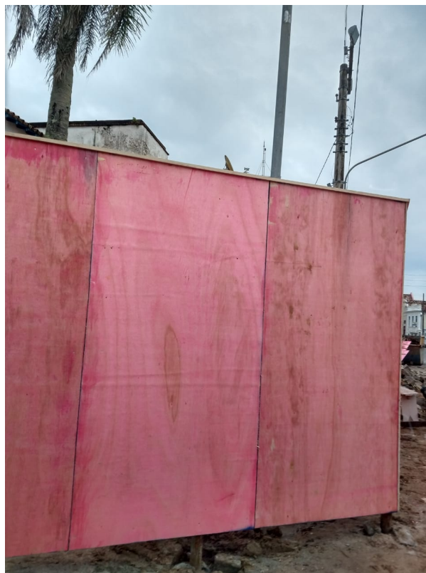
Ilustração 6: Tapume com execução completa de forma irregular.
