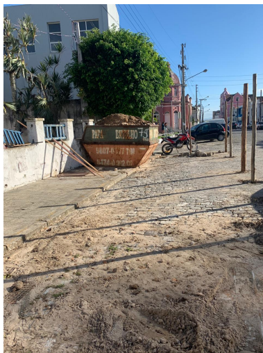
Ilustração 5: Escoras instaladas na Via Pública de forma irregular em 20 de Maio de 2019.
