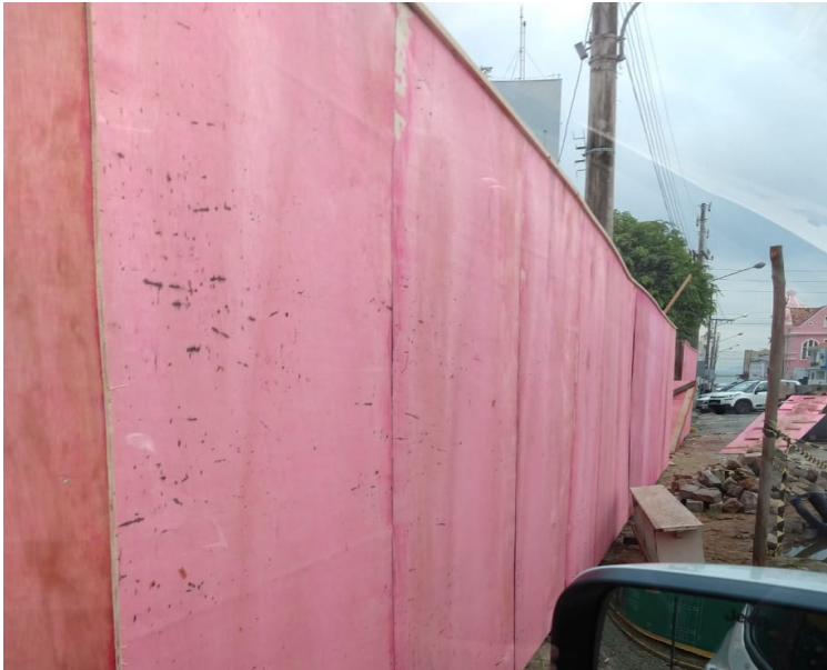
Ilustração 7: Tapume com execução completa de forma irregular.
