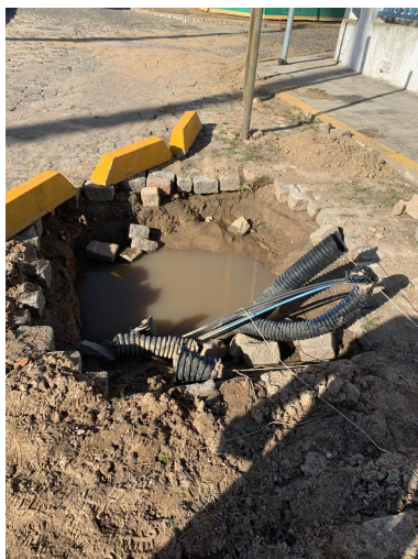
Ilustração 3: Dano causado na perfuração de 3 dutos e fiação da Rede Subterrânea.
